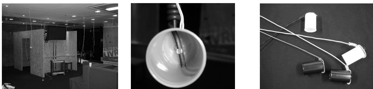
Fig. 24-25: instalação concluída e detalhes dos sensores (por Gabriela Carneiro)
